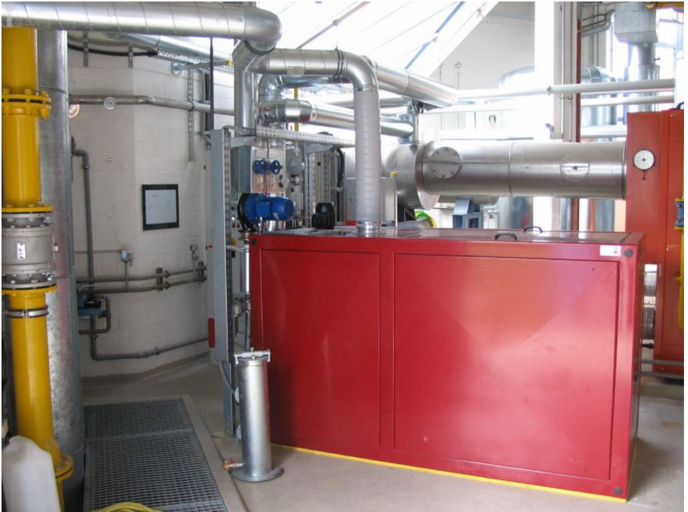
Foto: BHKW-Anlage Typ 2726-02, Fabr. COMUNA-metall
