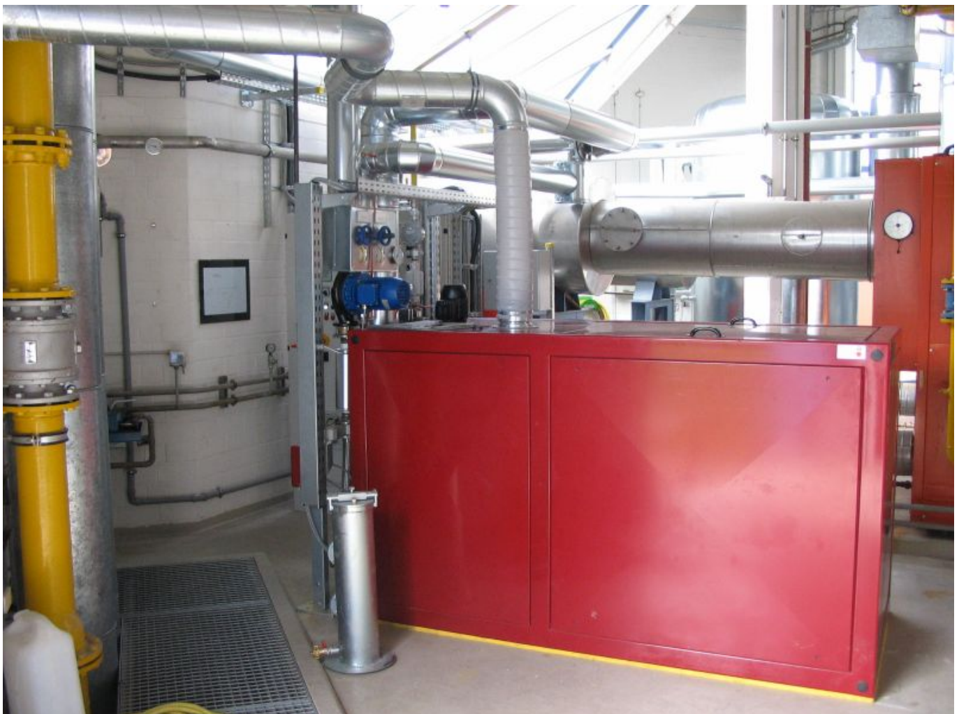
Foto: BHKW-Anlage Typ 2726-02, Fabr. COMUNA-metall
