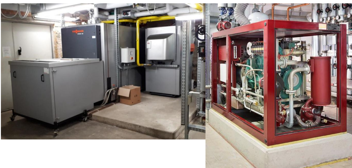
Spitzenlastkessel des Herstellers Viessmann Rechts: Das erste von zwei BHKW-Modulen des Typs 2726-02
