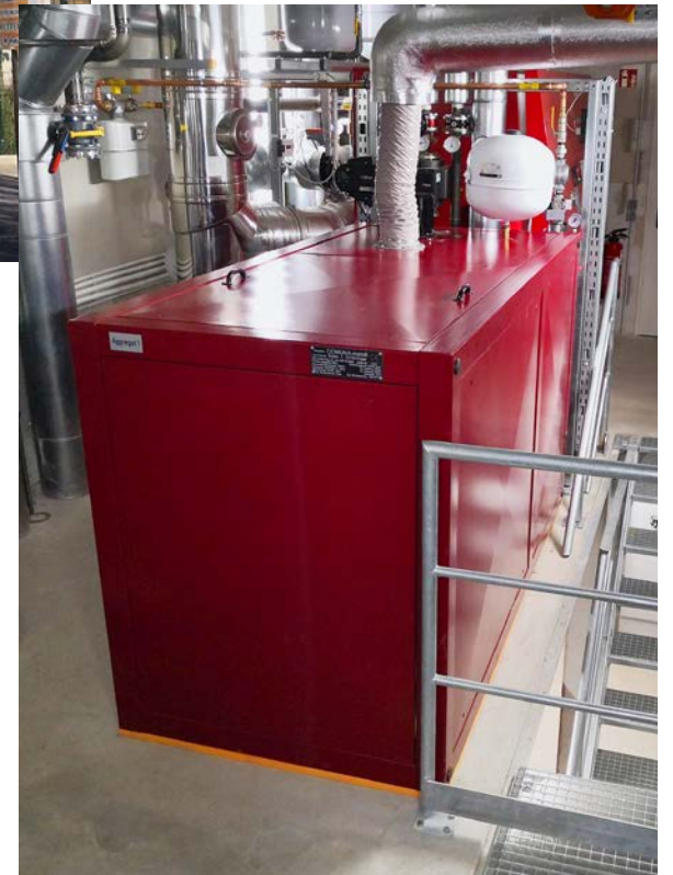
Für die Mittel- und Spitzenlastabdeckung wurde ein BHKW von Comuna Metall installiert
