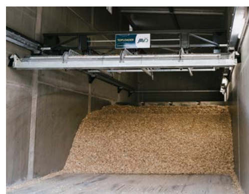
Das Brennstofflager befindet sich oberirdisch, die Kompaktierung findet im hinteren Bereich statt. Damit ist für die Anlieferung vorne immer ein freier Lagerplatz vorhanden
